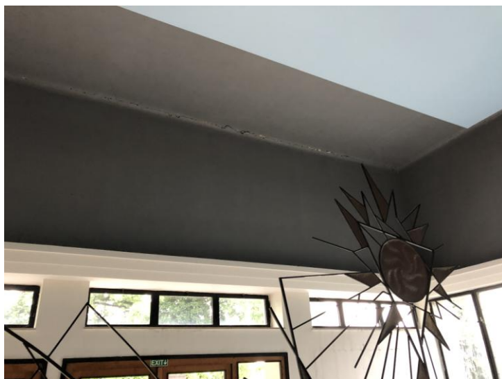
Foto, trhlina ve smuteční síni u stropu
