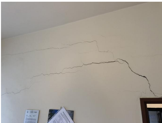
Foto, trhlina v kanceláři
